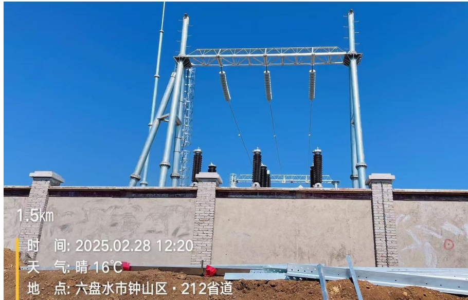
图 2-2 110kV 海开升压站间隔现场照片
